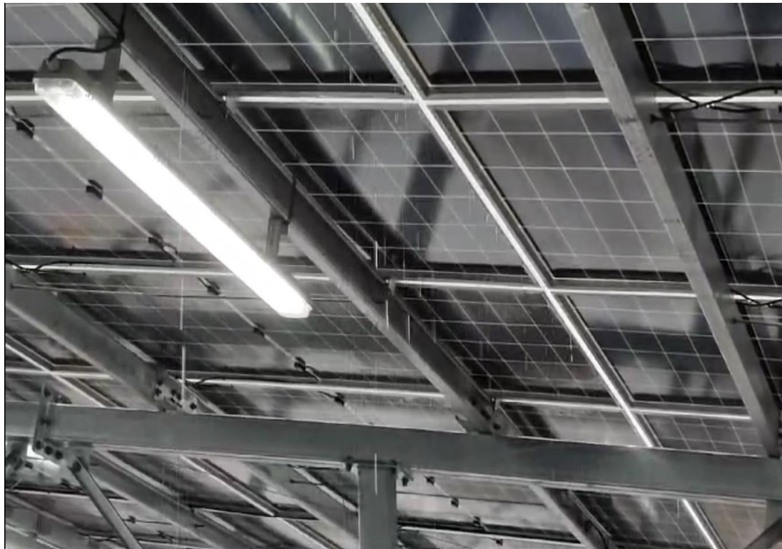
Figura 2 Gotejamento em Carport. Fonte: GoodWe.
