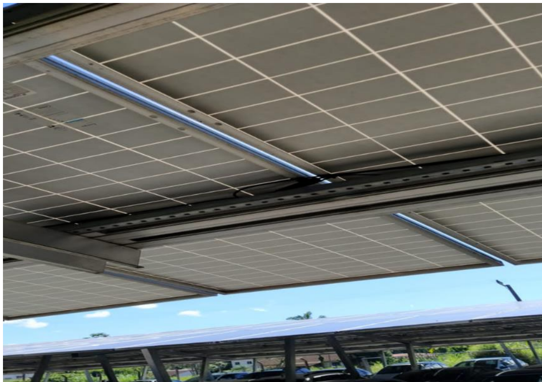
Figura 3 Espaçamento entre módulos. Fonte: GoodWe.
